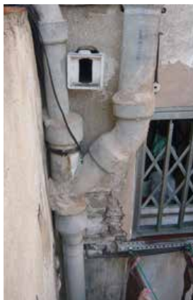
Figura 6. Conexión de bajantes de fibrocemento a uno de PVC.
